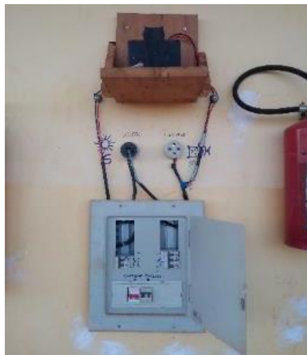
Figura 12 - Quadro de transferência.
