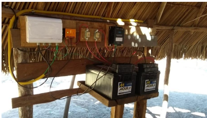
Figura 8 - Quadro de condicionamento de potência e suporte elevado para as baterias.
