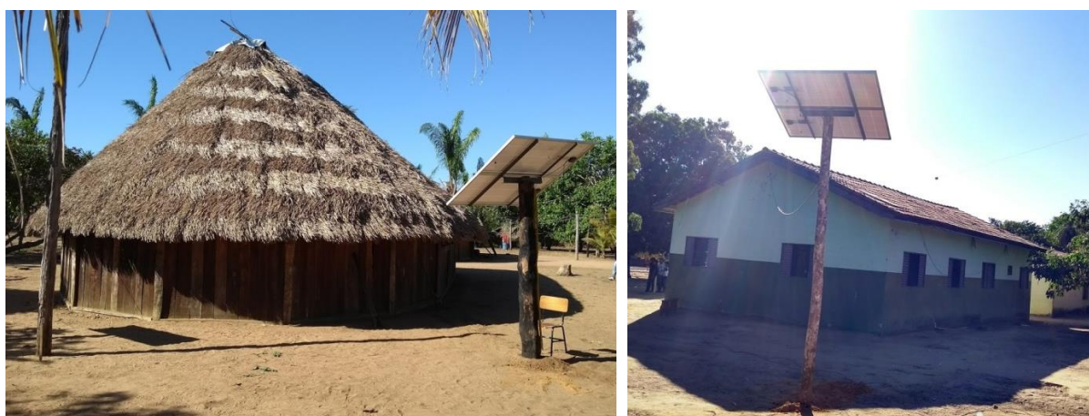
Figura 4 - Vista de dois sistemas instalados.
