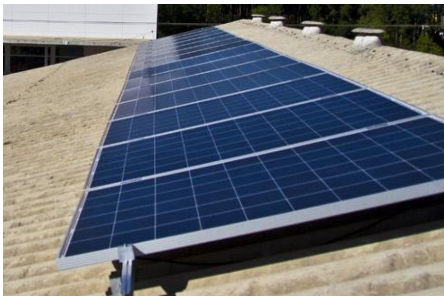
Figura 1 - Sistema PV de Silício Policristalino do Colégio Politécnico da UFSM. Fonte: http://site.ufsm.br/noticias/exibir/energia-que-vem-do-sol
