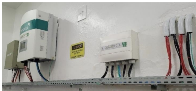
Figura 2 - Disposição de um dos inversores e quadros C.A. e C.C. Fonte - Elaborado pelos autores.
