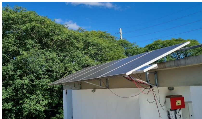
Fig. 1 – Sistema FV instalado no Laboratório de Energia Solar em Porto Alegre (UFRGS).
