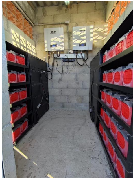
Figura 7 – Abrigo dos inversores bidirecionais e banco de baterias Fonte: Mariano (2021)
