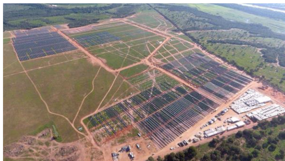
Figura 3 - Imagem aérea da construção das usinas Pirapora X e Pirapora IX – 2 (Martins, 2017).
