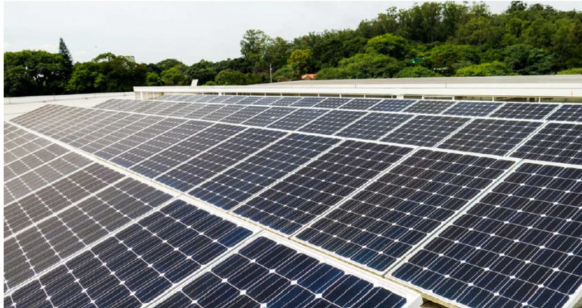
Figura 1 – Sistema BAPV instalado no edifício da Biblioteca Brasileira na Cidade Universitária da USP em São Paulo. Fonte: Pin, M. (2017).
