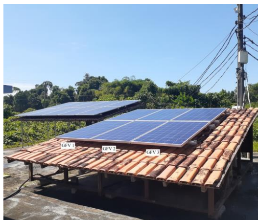
Figura 4 – Disposição de cada GFV no telhado.
