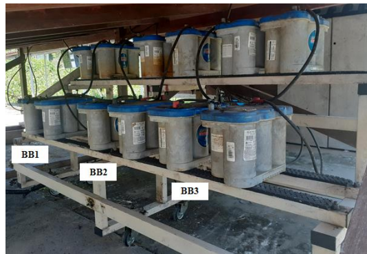
Figura 5 – Banco de baterias sob a cobertura do telhado.
