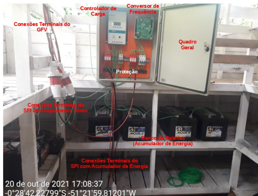
Figura 11 - Instalação da configuração mista na sede da ATAIC.
