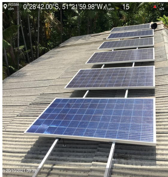
Figura 4 - Gerador fotovoltaico instalado na sede da ATAIC.
