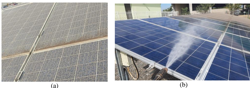
Figura 6: (a) Módulos sujos antes da realização da primeira limpeza (b) módulo durante a realização da limpeza
