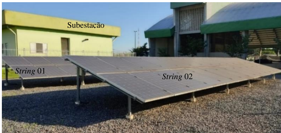
Figura 5: Sistema fotovoltaico do IFRO antes da limpeza.
