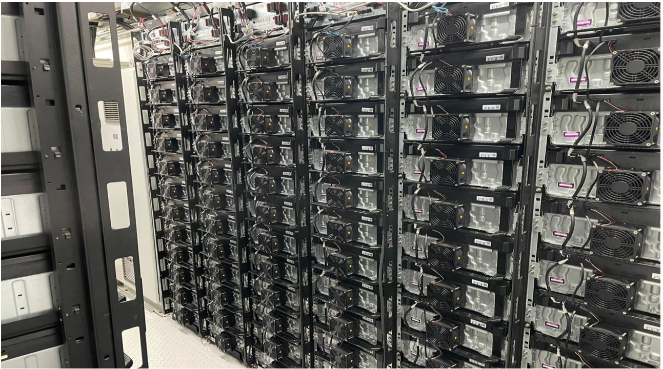
Figura 2 - Disposição física dos módulos de baterias em racks no container do BESS.
