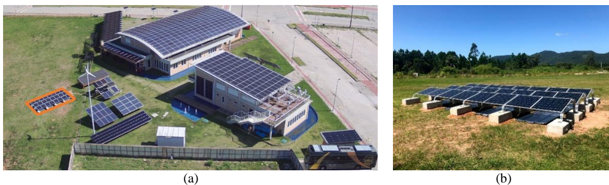
Figura 3 - Vista panorâmica do laboratório Fotovoltaica UFSC (a) e imagem do sistema EcoGround (b).
