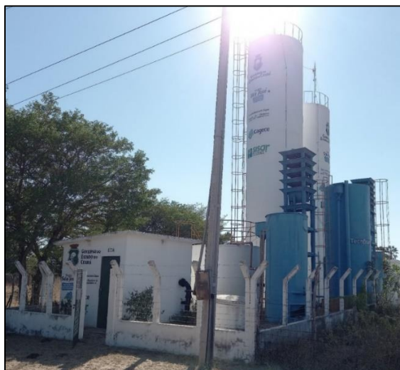
Figura 2 - ETA instalada na comunidade de Sítio Volta em Jaguaruana.
