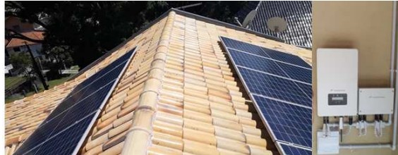
Figura 6. Módulos e inversor instalados na Residência Santa Felicidade (DO AUTOR)
