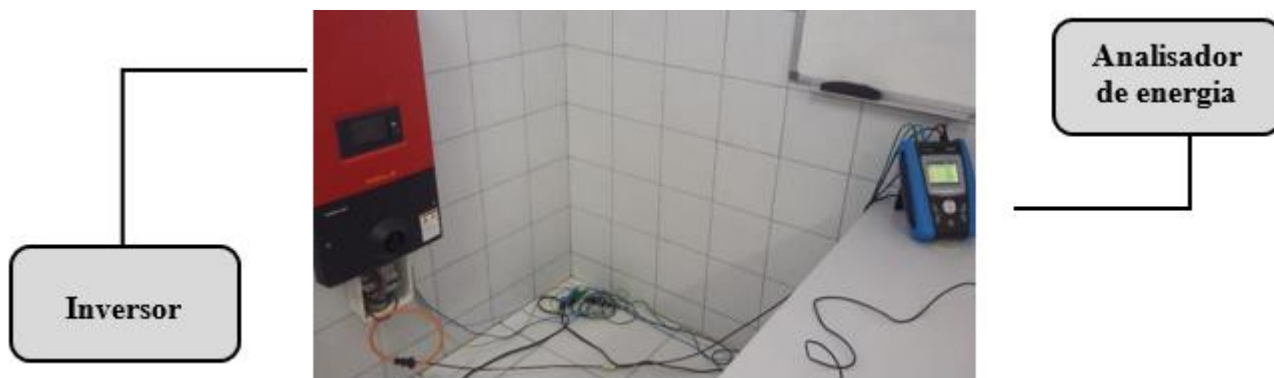
Figura 5 – Medição dos parâmetros elétricos de geração do SFCR na saída do inversor.
