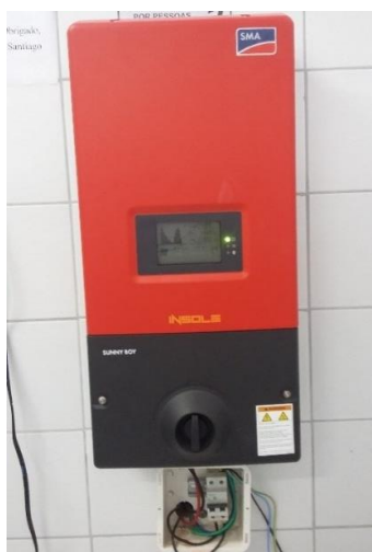
Figura 3 – Inversor e disjuntor de proteção do SFCR.
