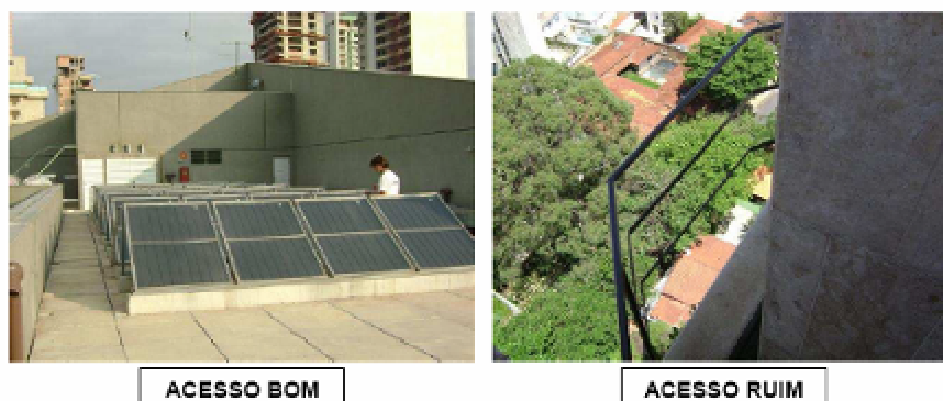
Figura 14 – Exemplos de acessibilidade em instalações de aquecimento solar
