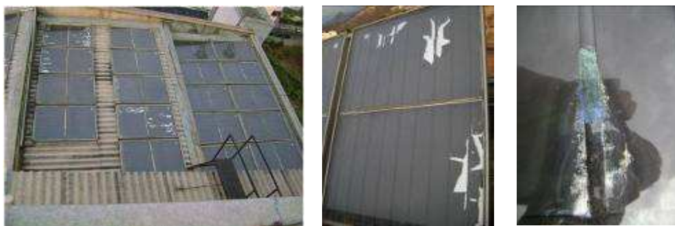
Figura 12 – Exemplos de problemas identificados de oxidação e deterioração de tinta identificados
