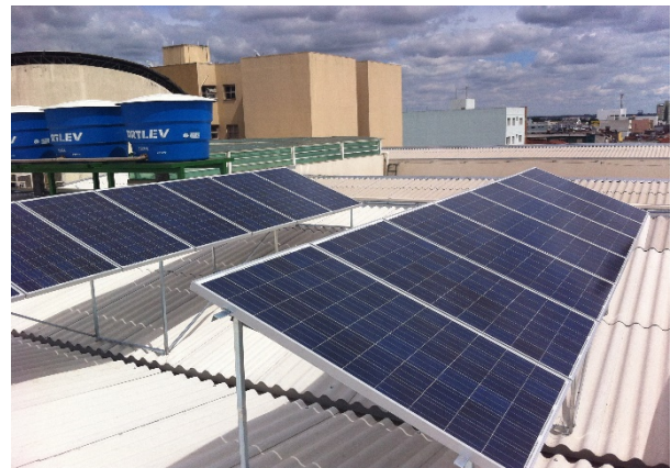
Figura 2 – UFV Miramontes em julho de 2013 (2 mesas com 7 módulos FV de 235 Wp/cada, totalizando 3,29 kWp)
