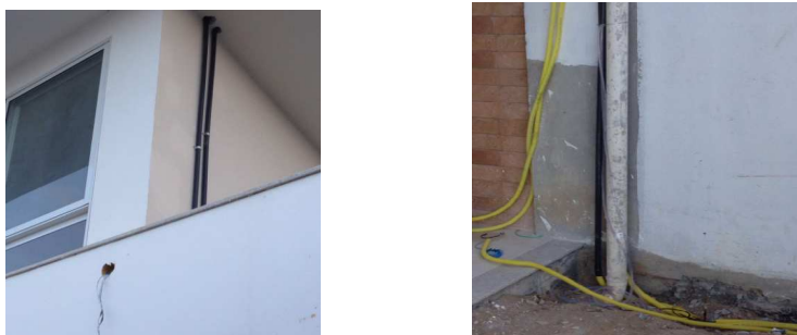
Figura 7 – Eletrodutos dos cabos fotovoltaicos. Fonte: TOTAL SOLAR.
