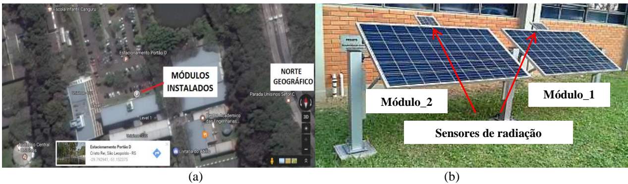
Figura 2 - (a) Localização da instalação dos módulos. (b) Módulos fotovoltaicos instalados.
