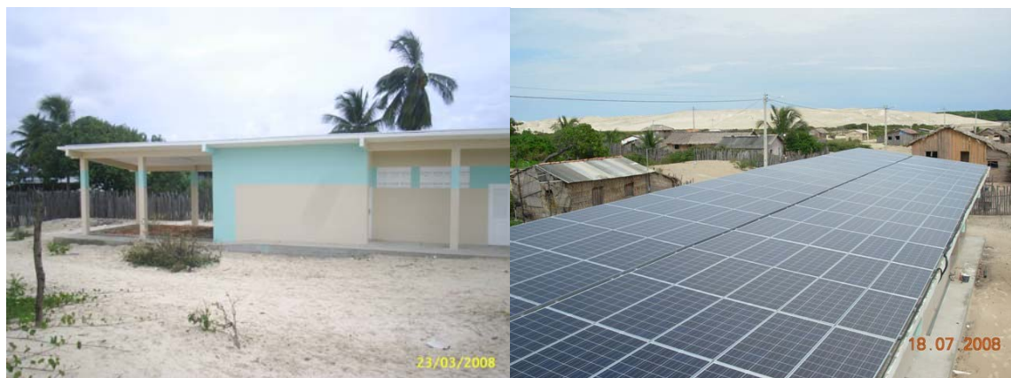
Figura 2 – Arranjo fotovoltaico de 20 kWp.
