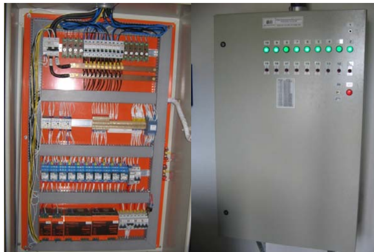
Figura 8 – Controlador de carga em operação.
