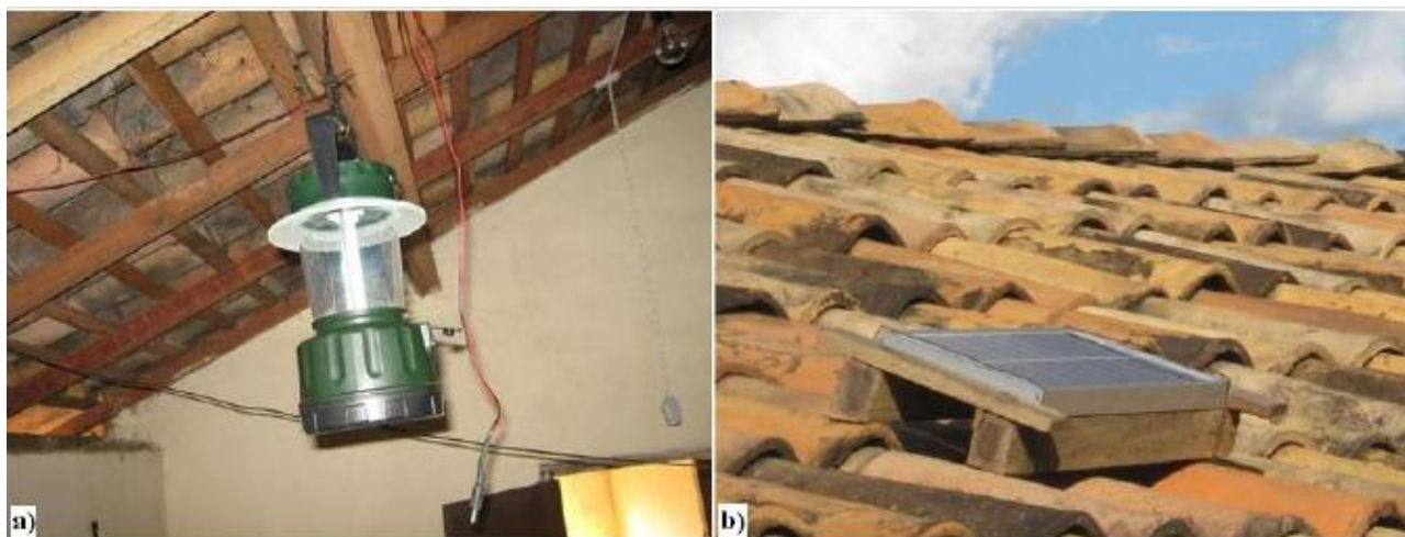
Figura 3 – “Lâmpião Solar” instalado em domicílio na localidade Pinga, 17 km de Oeiras - PI. Detalhe da instalação: a) interno e b) externo. [Foto: Alberto Moraes, set. 2009].
