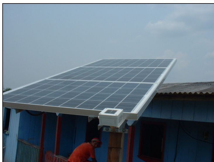
Figura 2 - Painel fotovoltaico e sensor de irradiação de IRAC2.
