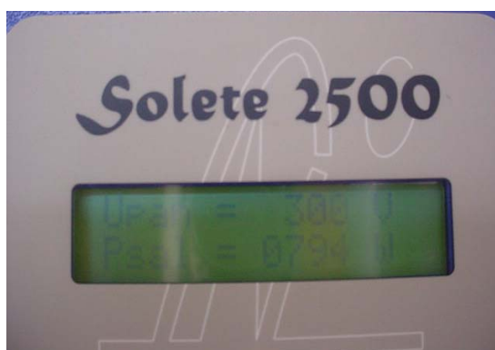
Figura 11 – Detalhe do display do inversor.
