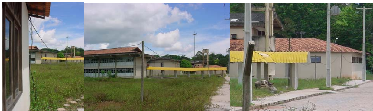
Figura 15 – Rede de alimentação provisória do prédio, com comprimento de aproximadamente 100 metros da subestação.
