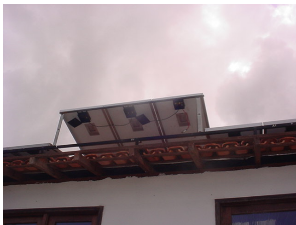
Figura 8 – Vista inferior de um dos grupos contendo 3 módulos.
