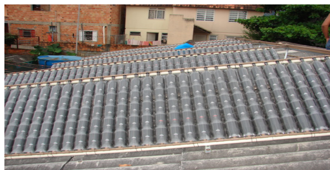
Figura 11 – Coletores solares, com 1.000 garrafas PET, instalados na Creche Chico Mendes, Florianópolis, SC
