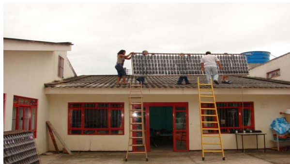
Figura 10 – Montagem dos coletores na Creche Chico Mendes, Florianópolis, SC
