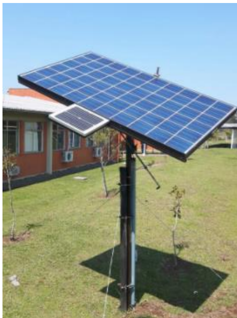
Figura 2 - Seguidor Solar instalado no campus do IFRS.
