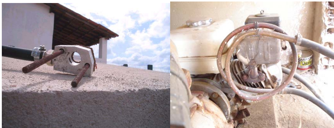
Figura 4: Adaptador para uso do biogás no motor e sistema de pré-aquecimento do biogás
