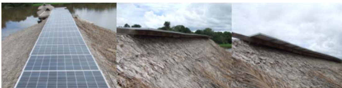
Figura 3 – Detalhes do gerador fotovoltaicos instalado no topo do bloco central.
