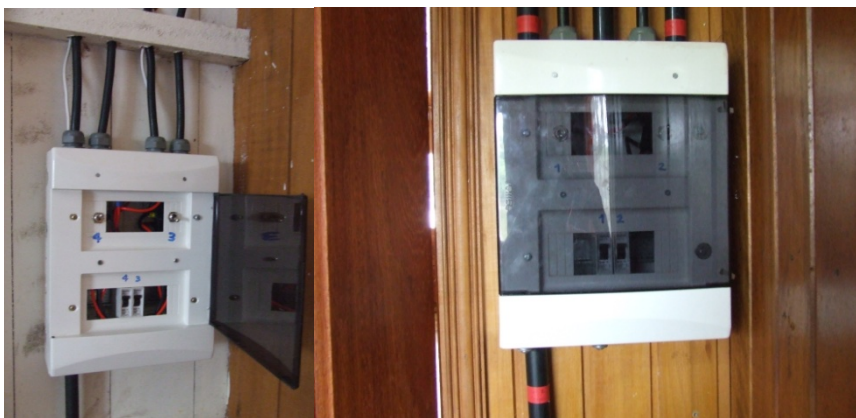
Figura 18 – Quadros de distribuição com chaves auxiliares que permitem a alimentação de dois circuitos por um mesmo inversor.
