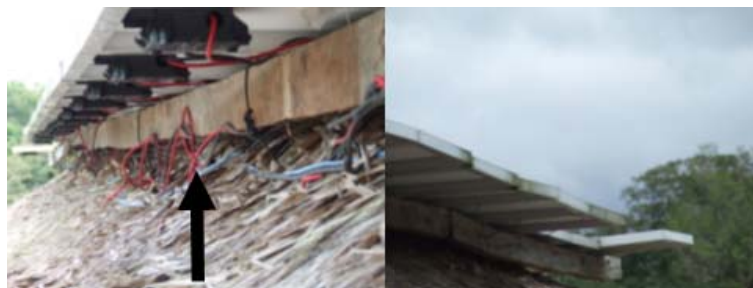
Figura 6 – Módulos amarrados na estrutura de madeira por meio de cabos elétricos e arames, além dos cabos expostos a radiação solar.
