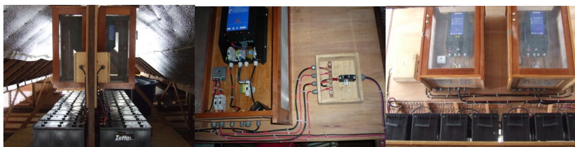
Figura 15 – Detalhes do banco de baterias e painel com os equipamentos de condicionamento de potência.
