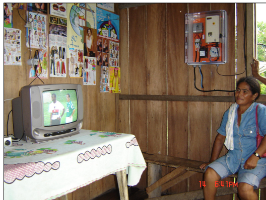
Figura 2- Quadro elétrico fixado na parede do interior de uma residência. [Foto: André Mocelin]
