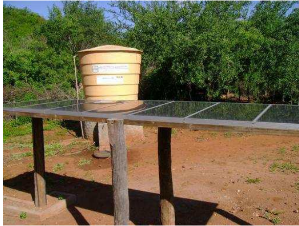
Figura 2 - Gerador fotovoltaico e reservatório do sistema de bombeamento de água na comunidade Garrincha, Serra da Capivara, PI.
