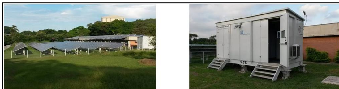
Figura 2 - Gerador fotovoltaico (esquerda) e eletrocentro (direita) do subsistema CTPV. Fonte: ALMEIDA et al., 2016.
