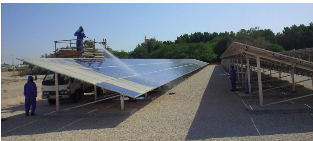
Figura 1: Módulos fotovoltaicos PV instalados na “University of Bahrain” (UoB). Composta por 2.088 painéis fotovoltaicos (policristalino), área total de 3.400 m 2 . FONTE: ALNASER et al, (2015).
