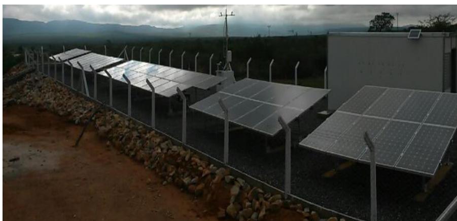
Figura 1 – Vista Geral do Sistema FV.
