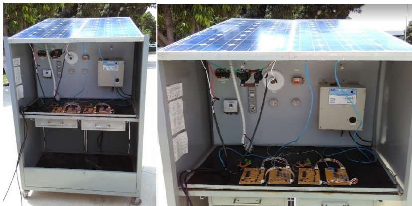
Figura 5 - Módulo didático fotovoltaico.
