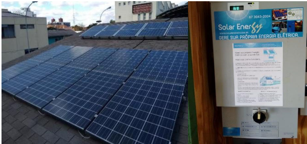
Figura 4 e 5 – Painel FV e inversor do Escritório Verde.
