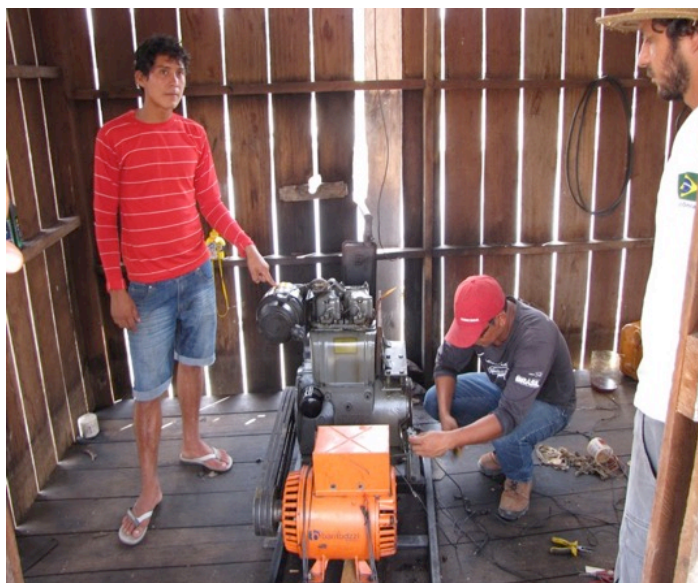
Figura 2- Grupo gerador a Diesel
