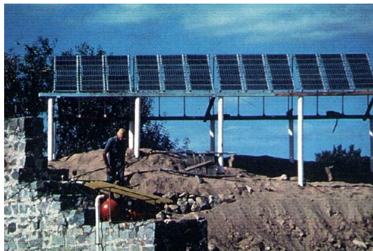
Figura 1 – Sistema fotovoltaico de bombeamento de 600 Wp instalado em 1981 (Fonte: Heliodinâmica).
