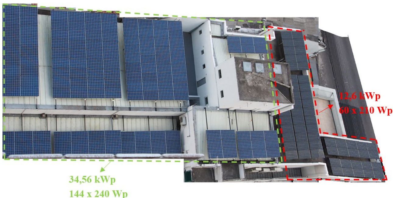
Figura 3 – Vista área do SFCR da UNICRED, com destaque para o sistema instalado na primeira etapa (em vermelho) e o instalado na expansão (em verde).
