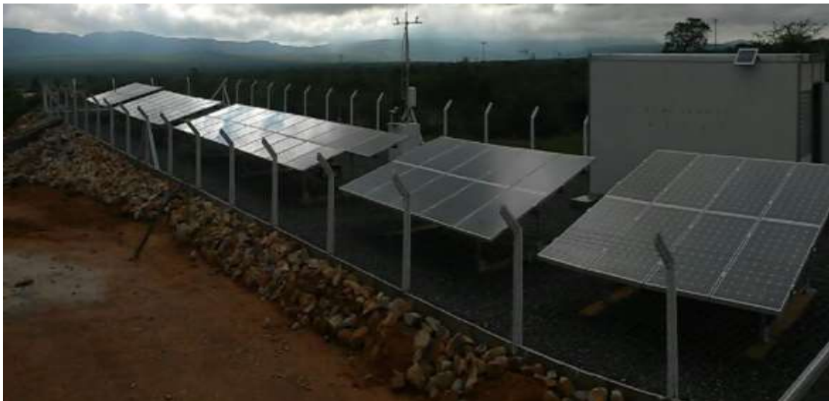
Figura 1 – Vista Geral do Sistema FV
