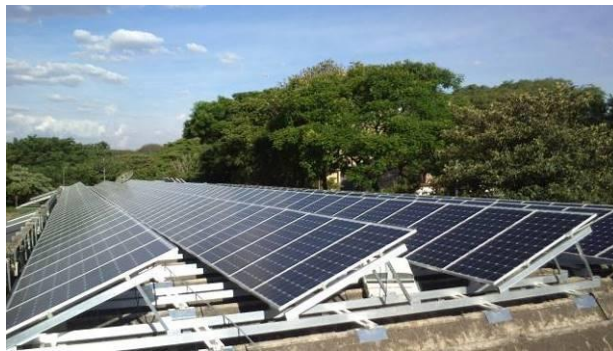
Figura 7 – Estruturas de suporte dos módulos e inversores / caixas de conexão do subsistema CRPV.
