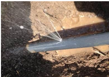
Figura 13. Tubulação superficial perfurada.
