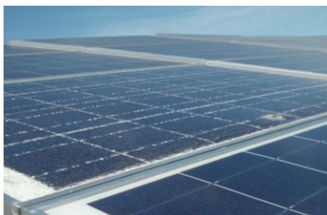
Figura 6. Detalhe de módulo com vidro quebrado.
