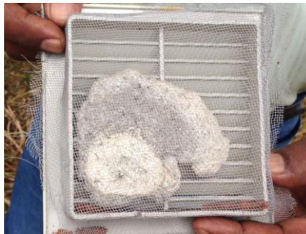
Figura 12. Obstrução da grade de ventilação do quadro de condicionamento de potência por ninho de vespas.
