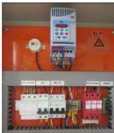
Figura 1. Quadro de condicionamento de potência com divisor de tensão avariado (superior à esquerda).
