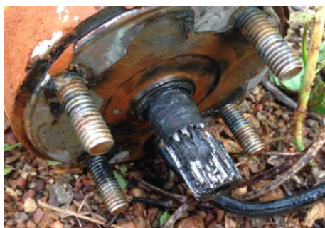
Figura 7. Ponta do eixo com sinais de corrosão.
