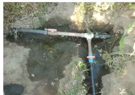
Figura 14. Vazamentos em conexões de ramal de sistema de irrigação.
