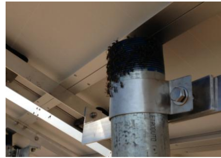
Figura 11. Colônia de marimbondos na estrutura tubular de sustentação dos módulos
