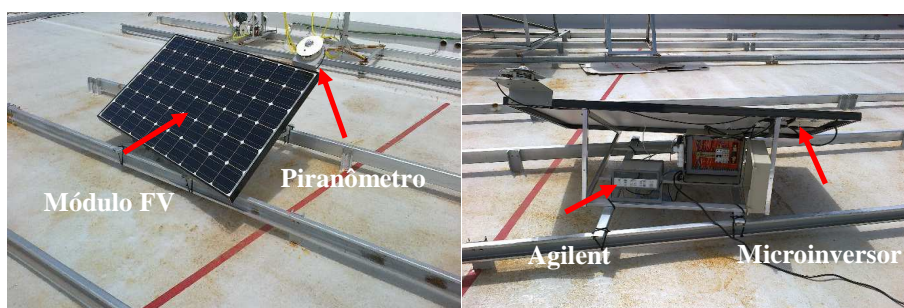
Figura 1 – Sistema fotovoltaico conectado à rede.
