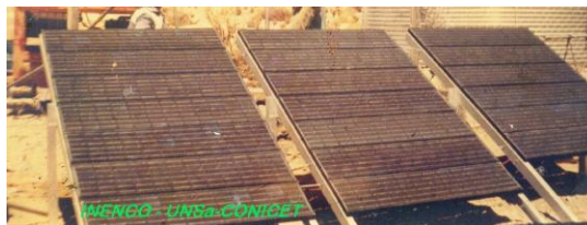
Figura 2- Foto de un conjunto de paneles
