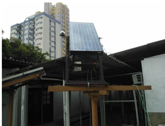
Figura 15 – Módulo Fotovoltaico instalado no Laboratório de Energia Solar.
