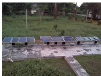
Figura 5 - Área de teste para diferentes módulos fotovoltaicos no GEDAE/UFPA.
