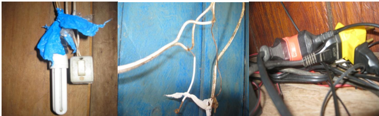
Figura 6 – Problemas com a fiação interna.
