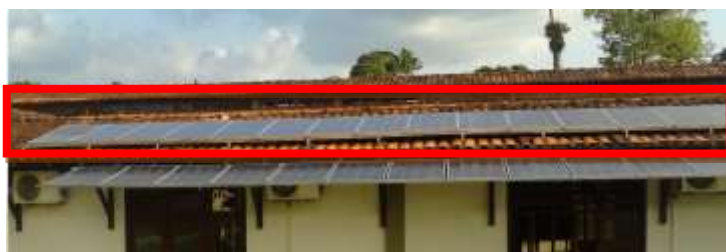
Figura 3 - Vista do gerador FV de 1,68 kWp, instalado no telhado da edificação.
