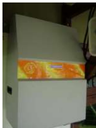
Figura 1 - Inversor de 1kW instalado no GEDAE.
