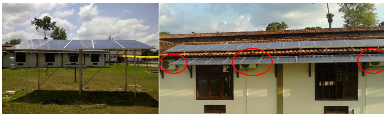
Figura 2 - Módulos instalados conectados à rede e detalhe de alguns condensadores instalados na edificação.
