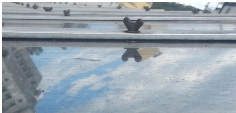
Figura 7 - Distribuição uniforme de sujeira sobre o gerador FV.
