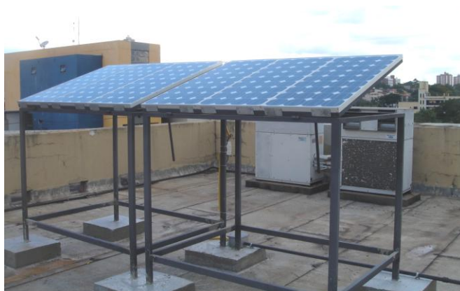
Figura 3- Foto do painel fotovoltaico composto por seis módulos, instalado no terraço do bloco E, Campus I, Área III, PUC-GO.
