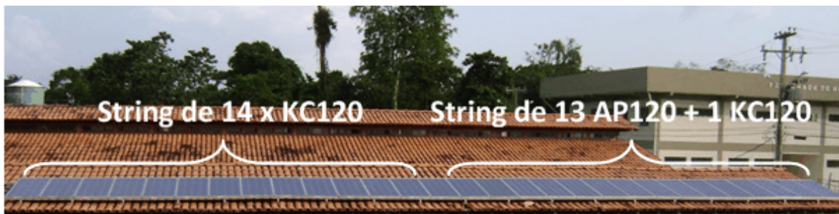
Figura 1– Gerador fotovoltaico sobre o telhado do GEDAE.
